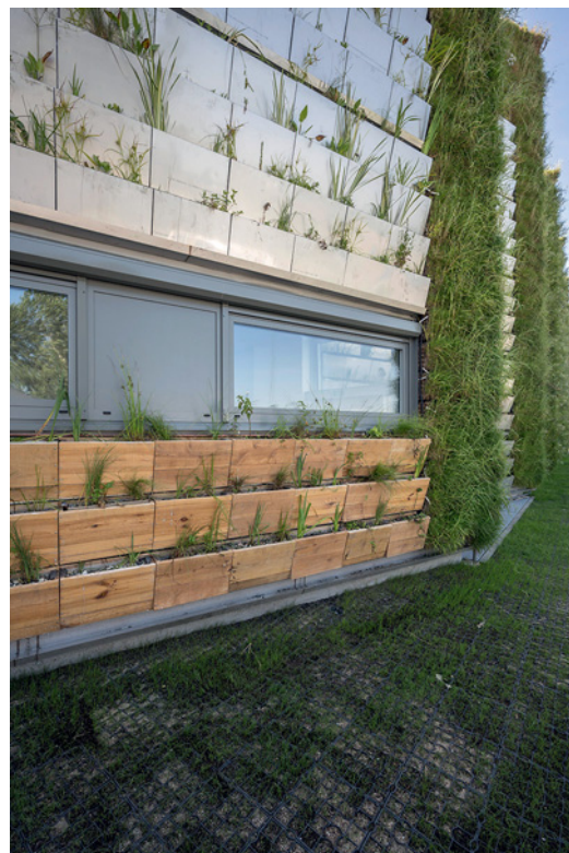
6 Detail fasádní kořenové čistírny odpadních vod; znečištěná voda je předčištěna v nádrži umístěné na střeše haly a následně protéká přes vertikální filtr do další jímky, odkud je dále čerpána například k závlaze.
