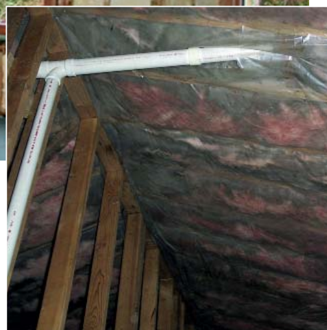
Zkondenzované páry jsou příčinou vzniku zdraví nebezpečných plísní
